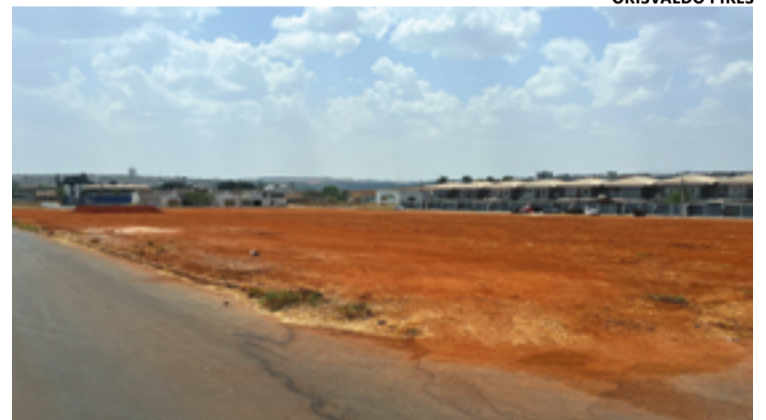
Área onde será construída a sede própria da Câmara, no Residencial Cerejeiras
